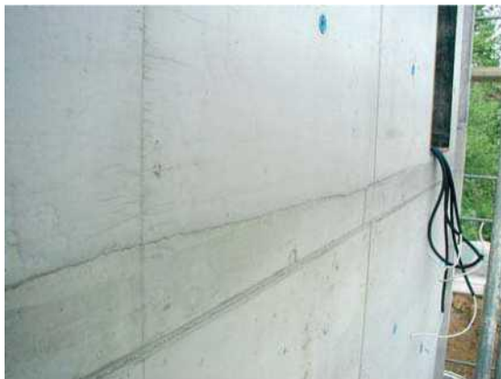
Εικόνα 7 - Εμφανής αρμός εργασίας (μη αποδεκτός)
