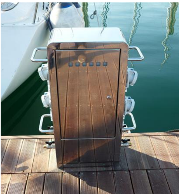
Εικόνα 4: Κιβώτιο παροχής νερού και ενέργειας
