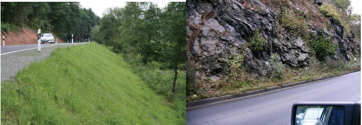
Πρανή επιχωμάτων H > 3m και ορυγμάτων με κλίση υ:β > 1:3 – Κατηγορία κινδύνου 4
