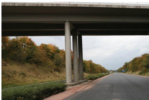
Βάθρα που δεν έχουν υπολογιστεί έναντι πρόσκρουσης οχημάτων – Κίνδυνος κατάρρευσης φερόντων στοιχείων ⇒ Κατηγορία κινδύνου 1
